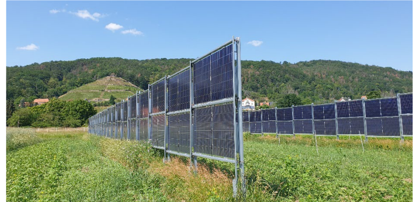
Agri-Photovoltaik-Versuchsanlage der HTW in Pillnitz, Foto: LHD
