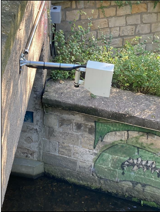
Abb. 8: Messstelle Prießnitz FP 2, Radarsonde zur Abflussmessung und im Hintergrund Schaltkasten, 02.09.2021
