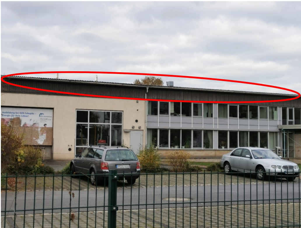
Abbildung 3: Wellblechverkleidung im oberen Fassadenbereich; mögliches Habitat für Fledermäuse
