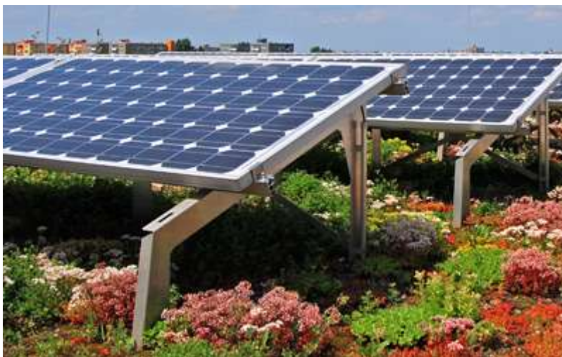
Abbildung 3: Kombination Gründach und Photovoltaik (Foto: Zinco)
